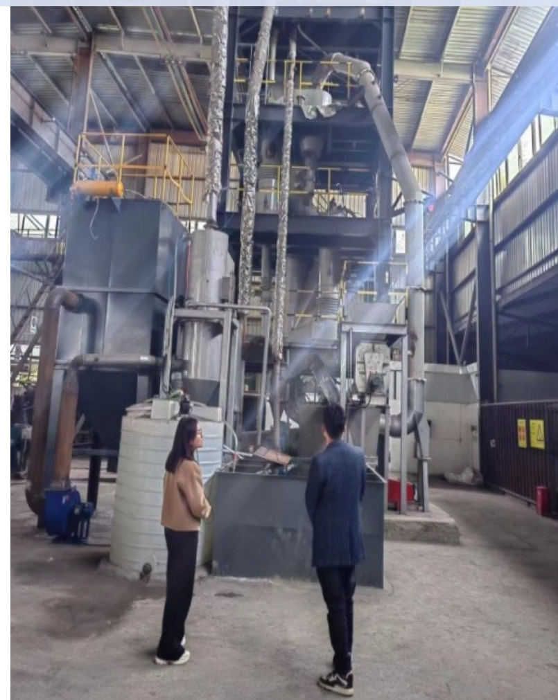
本项目悬浮煅烧设备
